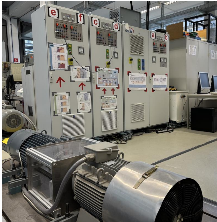
Abbildung A.1: Linke Frontansicht des Prüfstands (siehe Abbildung 3.1) – Die ASM (vorne) treibt den gekoppelten PMSG (links) an, die sechs Umrichter [a] bis [f] befinden sich in den entsprechend beschrifteten Schränken und am rechten Bildrand ist der Arbeitsplatz des Benutzers zusammen mit dem echtzeitfähigen PC ( RTAI-Linux )
