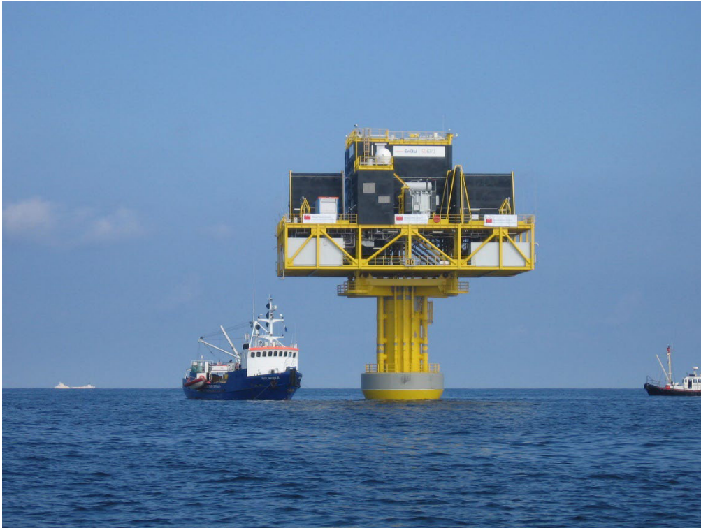
Abbildung 16: Umspannwerk des Offshore-Windparks Baltic 1 auf Monopile Gründungsstruktur (Schöne und Richter 2010)
