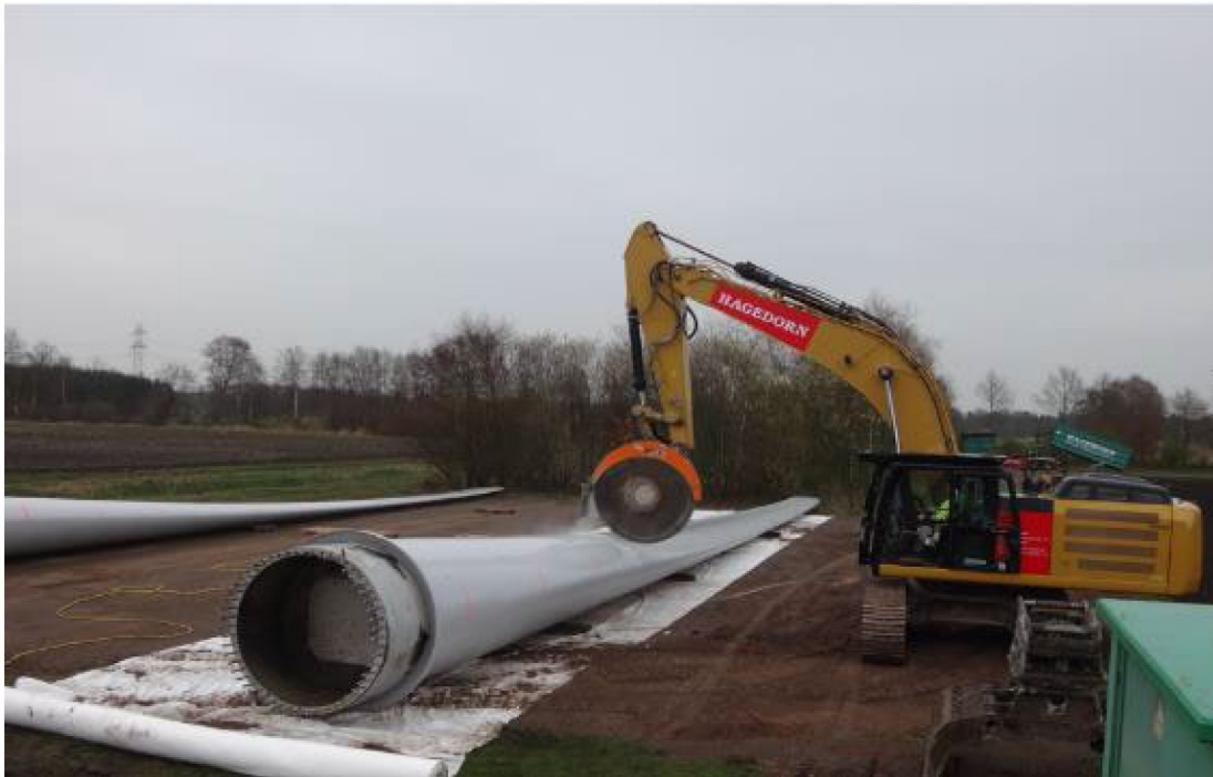
Abbildung 60: Rotorblatzerkleinerung mit einer Bagger-Beton-Kreissäge mit Nebeldüse. (Rausch 2021) Abdruck mit Genehmigung von Nehlsen AG.
